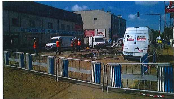
Figure 8 : dommages RN3 à Livry-Gargan suite à rupture longitudinale sur conduite DN 300 en fonte grise - 24 juin 2015
