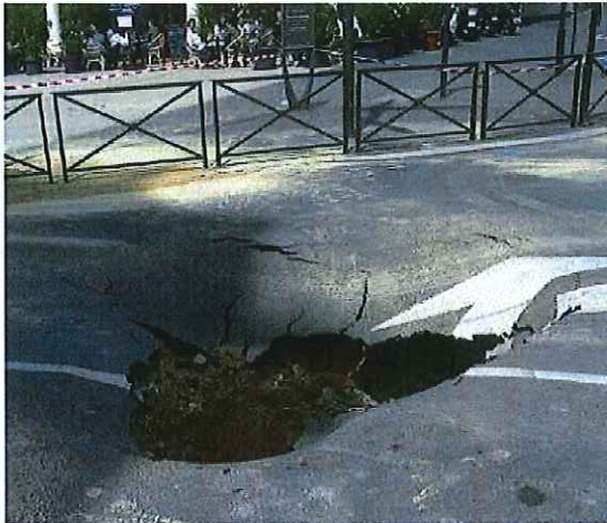
Figure 7 : dommages rue Georges Lebigot à Villejuif suite à rupture canalisation DN 250 en fonte grise – 12 mai 2015
